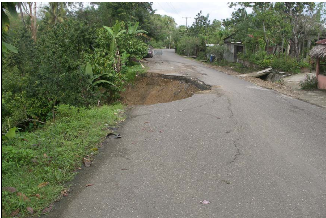
Foto 6.3. Deslizamiento en la carretera Gaspar Hernández-Tenares
