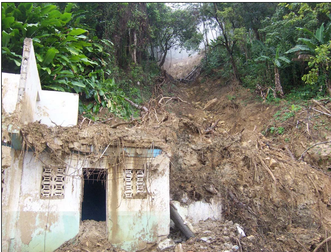
Foto 6.2. Deslizamiento al oeste de José Contreras
