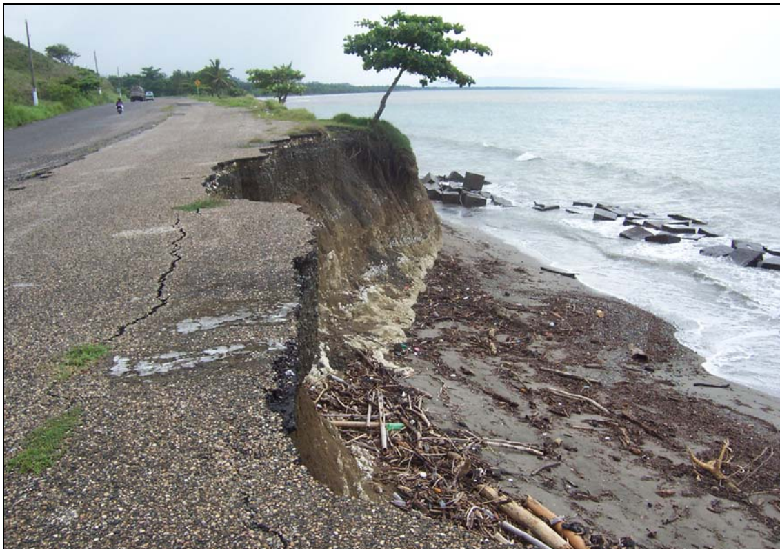
Foto 6.4. Erosión del litoral en la carretera Gaspar Hernández-Río San Juan
