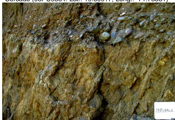
Foto 38 - Pequeñas fallas normales N10°E/80°SE en las lutitas y siltitas de la Fm. Cercado. No hay evidencia de movimientos en los depósitos de terrazas altas suprayacentes (03PU9741: Lat.: 19.55794; Long.: -71.54192)
