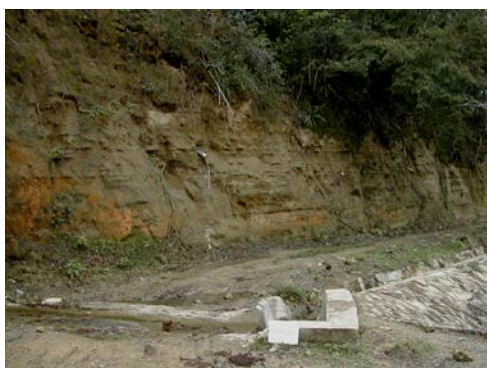
Foto 87 - (03PU9960) - Pie del muro de la presa de Chacuey: areniscas gris-marrón-naranja, horizontales, con lentejones composición más carbonatada. Se notan los drenajes de prevención de la represa
