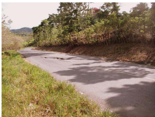
Fig. 189: Deslizamiento de laderas Falla actual activa en la carretera Moca La Cumbre 25PU9794 Lat.: 19.48406/Long.: -70°51271
