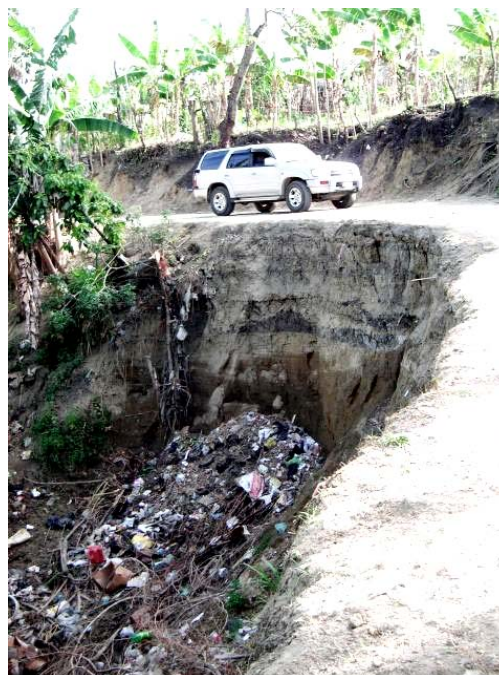
Fig. 137: Unidad de Licey al Medio - Vista de un derrumbe en arcillas expansivas calcáreas con varias intercalaciones de niveles orgánicos negros.
