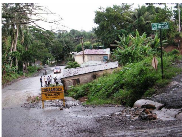
Fig. 196: Riesgos de deslizamientos - Deslizamientos en los Méndez el la ribera derecha del Arroyo Barracón en Moca
