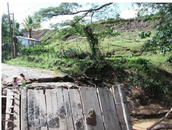
Fig. 194: Riesgos de deslizamientos Masa deslizada y destrucción del puente en la ribera derecha del Arroyo Colorado en San Antonio
