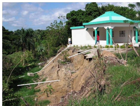
Fig. 197: Riesgos de deslizamientos Talud deslizado en el poblado de San Antonio (Arroyo Colorado)
