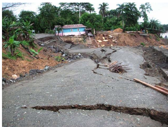
Fig. 199: Riesgos de deslizamientos Deslizamiento de tamaño medio con importante daños a la carretera Moca La Vega
