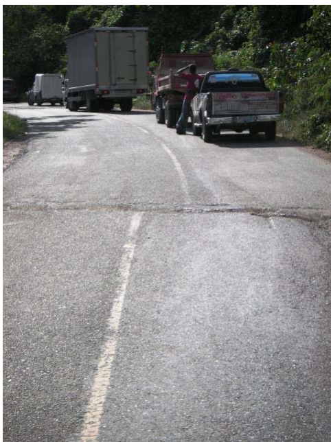
Fig. 177: Deslizamiento de laderas Falla actual activa cruzando la carretera Moca La Cumbre en superficie de la zona deslizada de La Cumbre - Cabirma.
