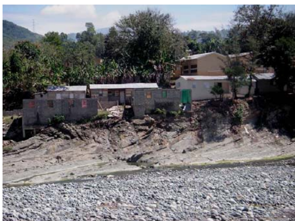
Fig. 224: LIG3 - Vista de las alternancias del a Fm. Jánico en La Baitoa y los daños relativos a la crecida del 12 de diciembre 2007
