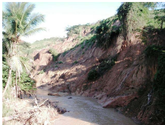
Fig. 118: Unidad de Licey al Medio - Farallones de arcillas arenosas derrumbadas en coladas sub líquidas.
