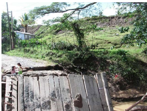
Fig. 181: Deslizamiento de laderas - Vista de un deslizamiento en las arcillas de la Unidad Licey al Medio
